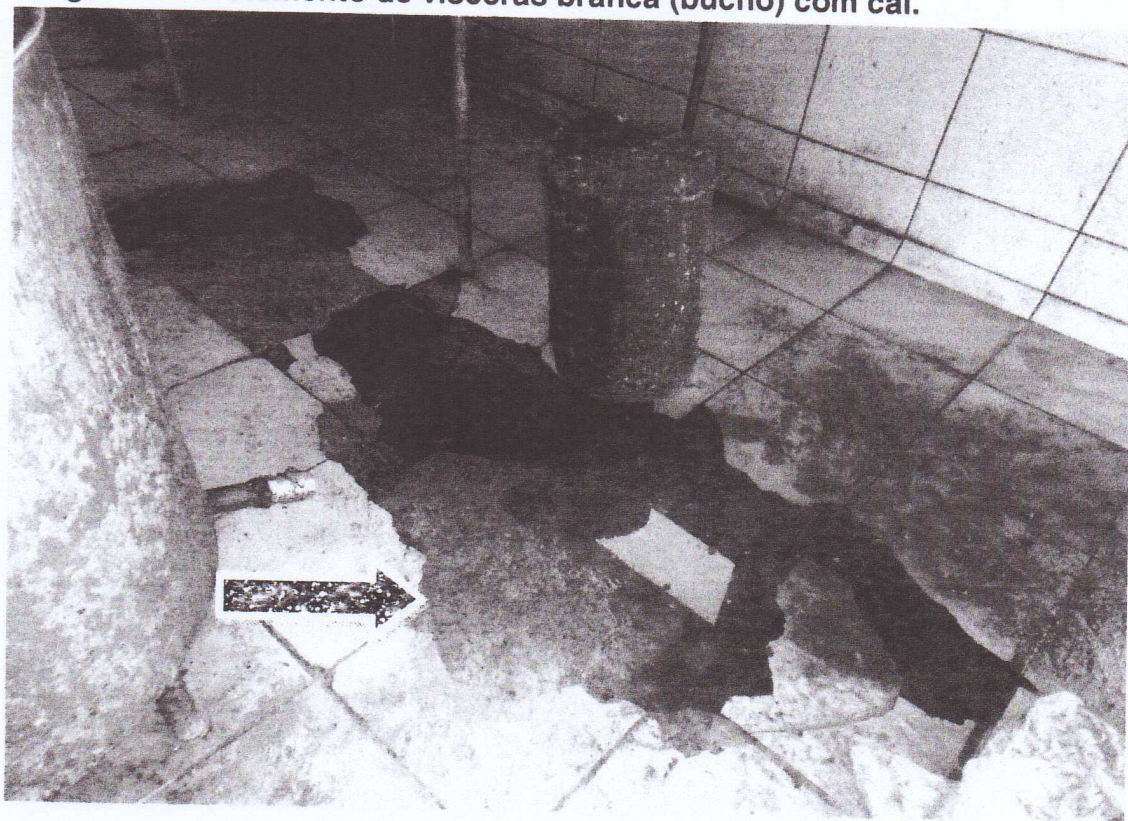
Imagem 16: Piso com acúmulo de águas servidas.
